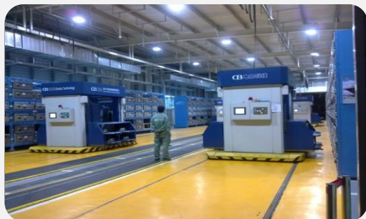
2 上海世博园电动公交车充换电站
