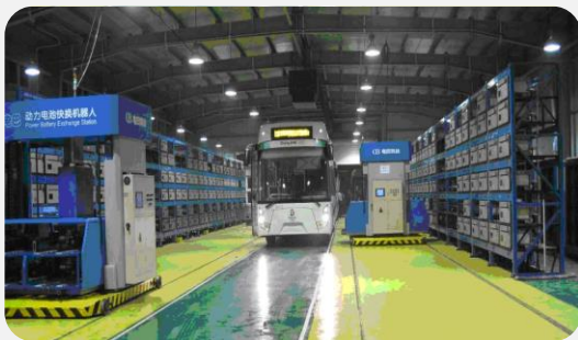
4 青岛薛家岛电动公交车充换电站
