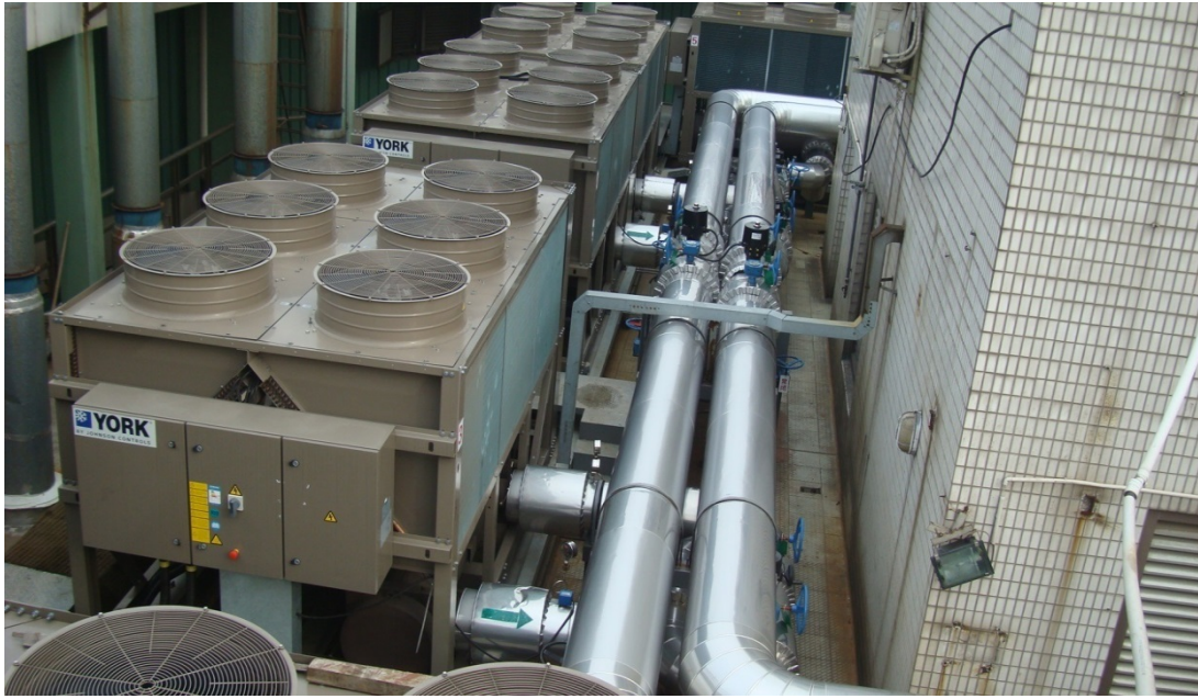
图 4-32 空调系统新螺杆式风冷热泵机组
