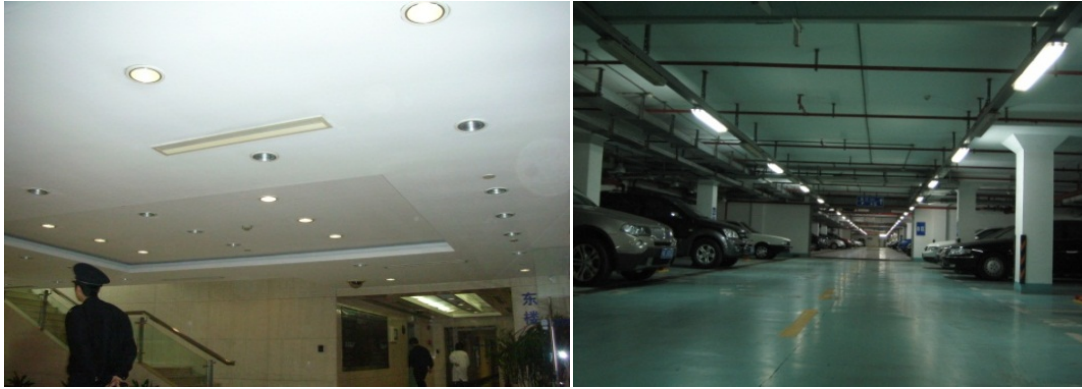
图 4-8 改造后公共区域和地下车库照明情况
