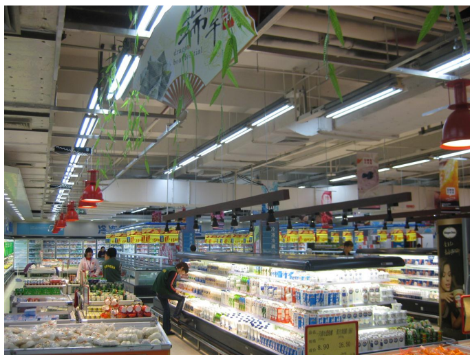
图 4-24 照明系统改造后的照片
