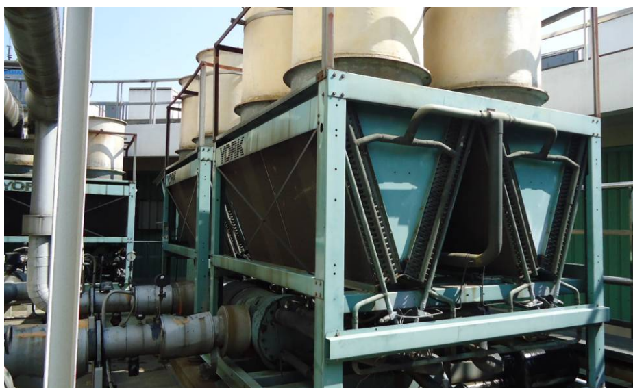
图 4-31 空调系统原有活塞式风冷热泵机组
