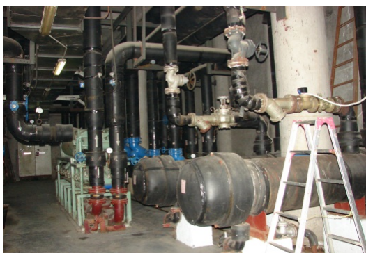
图4-5 改造前热交换器
