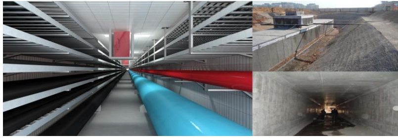
图 5-41 深圳光明新区共同管沟实景
