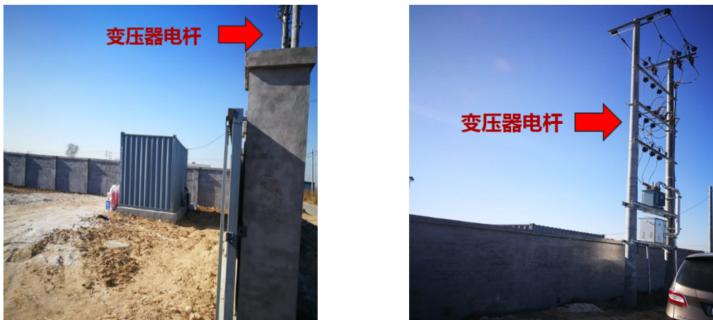
图3.15 LNG供气站与站外配电设施距离不足（重大隐患）
