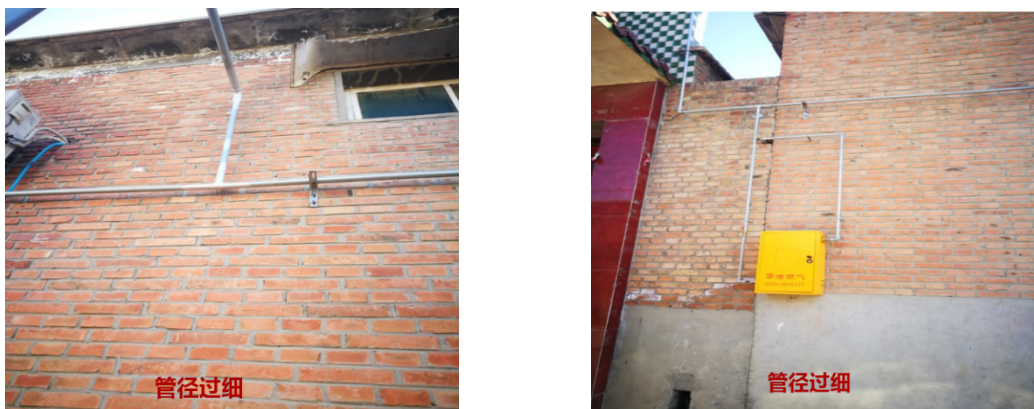
图3.31 管径过细，过流能力低，用户反映只能关闭壁挂炉才能做饭（设计导致供气不足）
