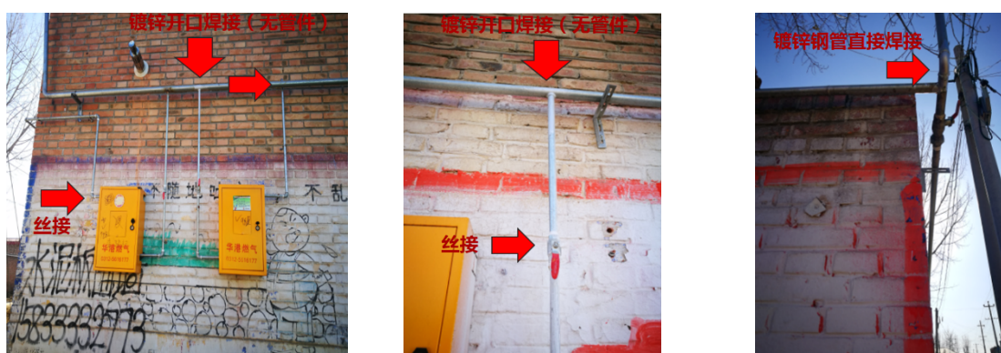
图3.26 镀锌管直接开岔口，直接焊接，但也有用管件的，标准不统一（中级隐患）
