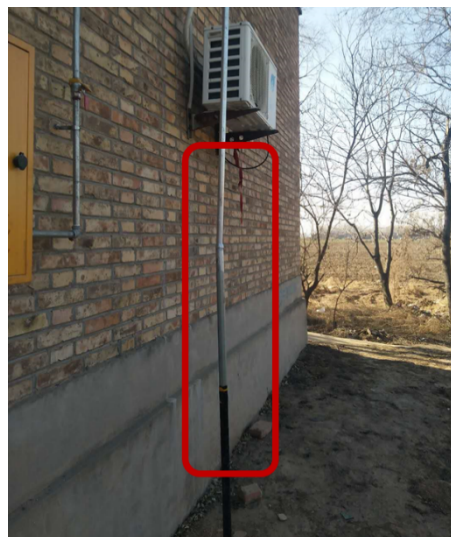
图3.19 出地面管道无保护台（重大隐患）
