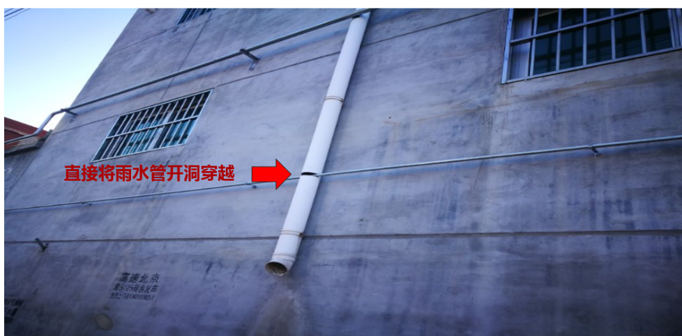
图3.24 管道穿越现状雨水管，未采用任何避让、保护措施，直接野蛮穿越（中等隐患）
