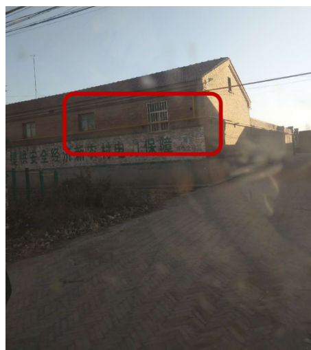
图3.22 燃气管挡窗户（重大隐患）
