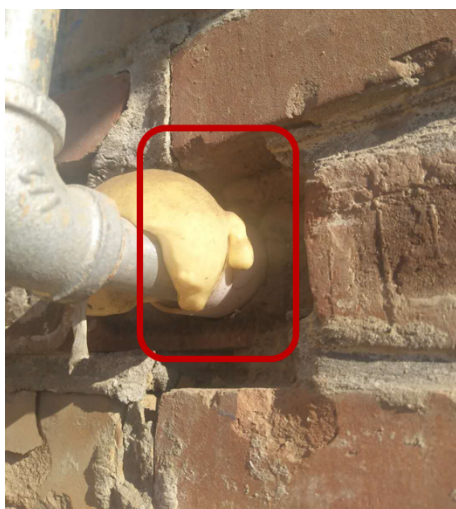
图3.21 穿墙套管为塑料管（重大隐患）
