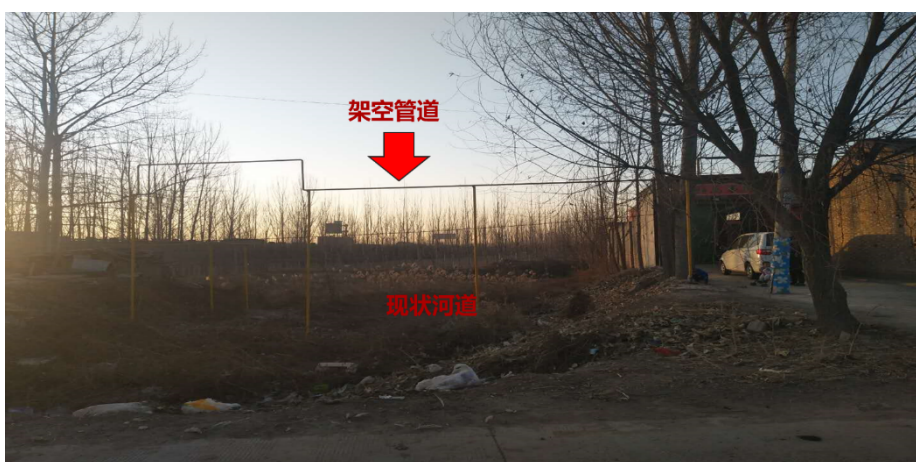
图3.20 燃气管线穿越河道未采用直埋，在河道中央设置支架（重大隐患）
