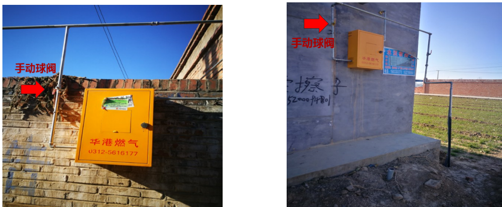
图3.25 阀门处均无固定关卡（中等隐患）
