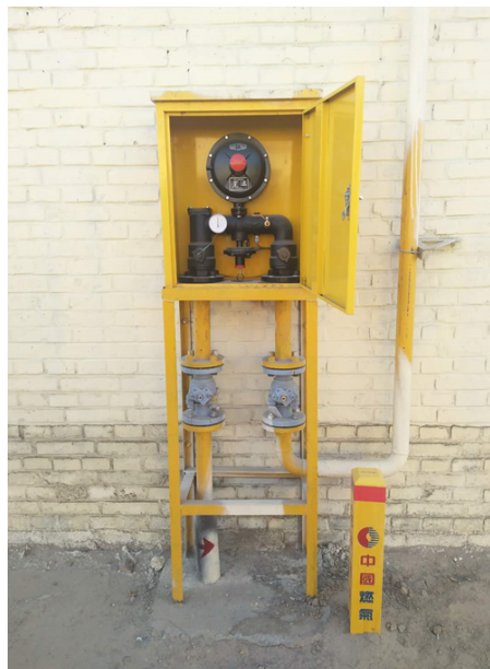
图3.29 燃气设施未闭合（中等隐患）
