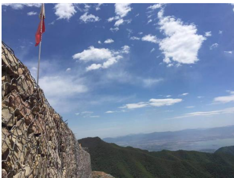
（海绵式排水沟和石笼墙，监理方供图）
