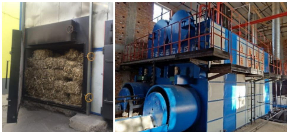
图 6-9 生物质打捆直燃供热系统
