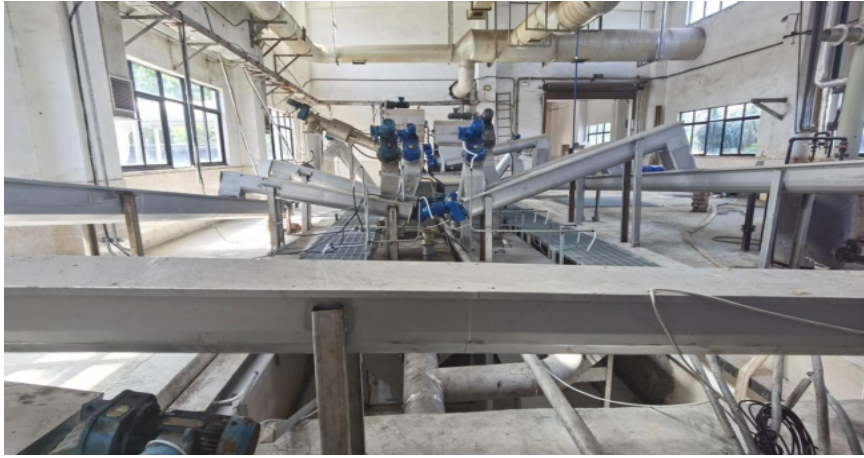
市政粪便预处理车间
