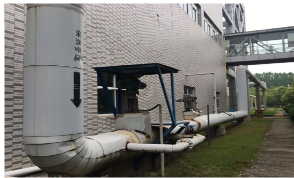
#1 机组抽气出口管道
