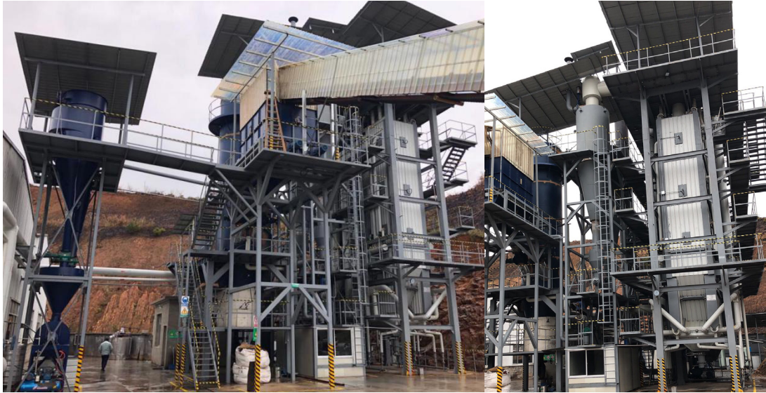
浙江丽水生物质气化替代天然气（煤）供热项目
