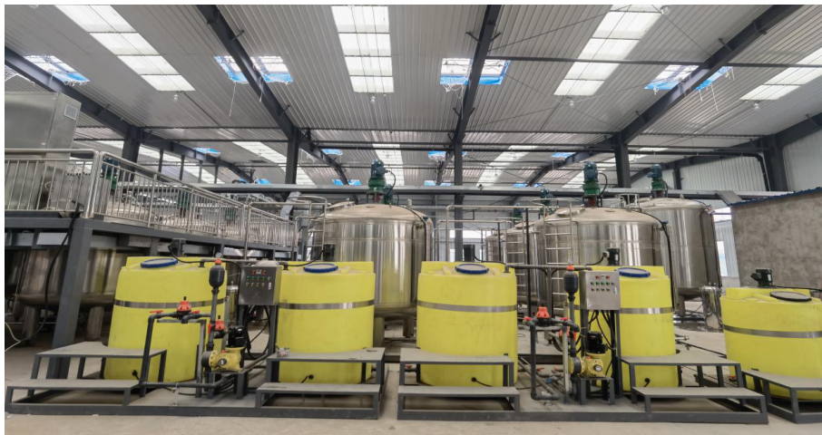
液体有机肥生产装置
