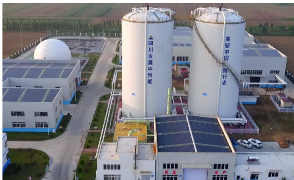
乳山项目厌氧发酵罐
