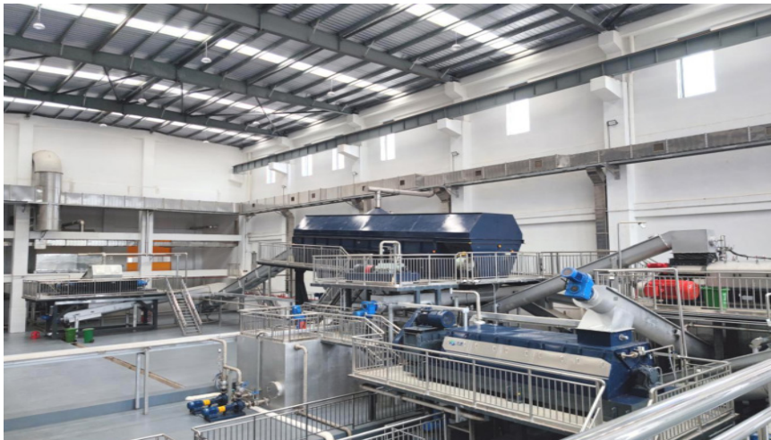
厨余垃圾预处理设备
