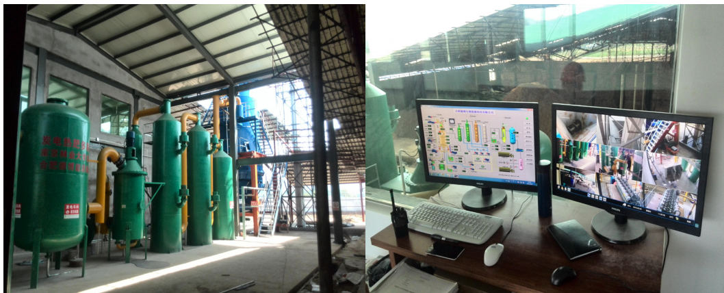
云南西双版纳生物质气化替代天然气（煤）供热项目
