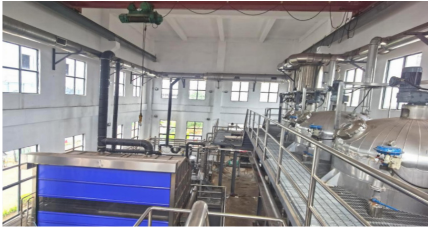
废弃油脂预处理车间
