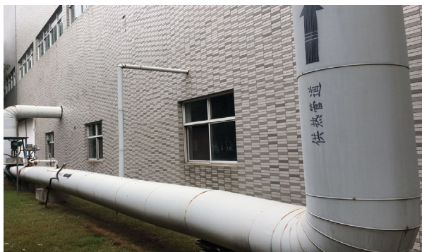
厂区供热管道
