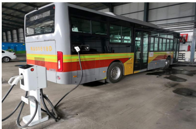
图 5 哈尔滨市新能源公交车的室内充电站
