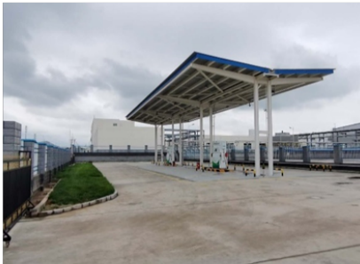
东望山加氢站
