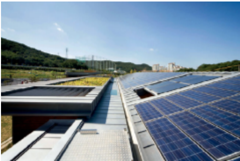
图 2-16 屋顶太阳能光伏
