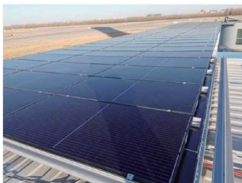
(a) 光伏板屋面
