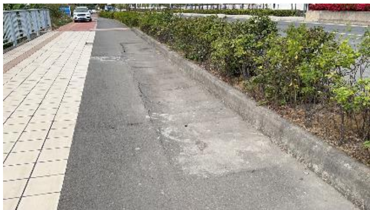
港前路与文涌相交处，非机动车道铺装破损
