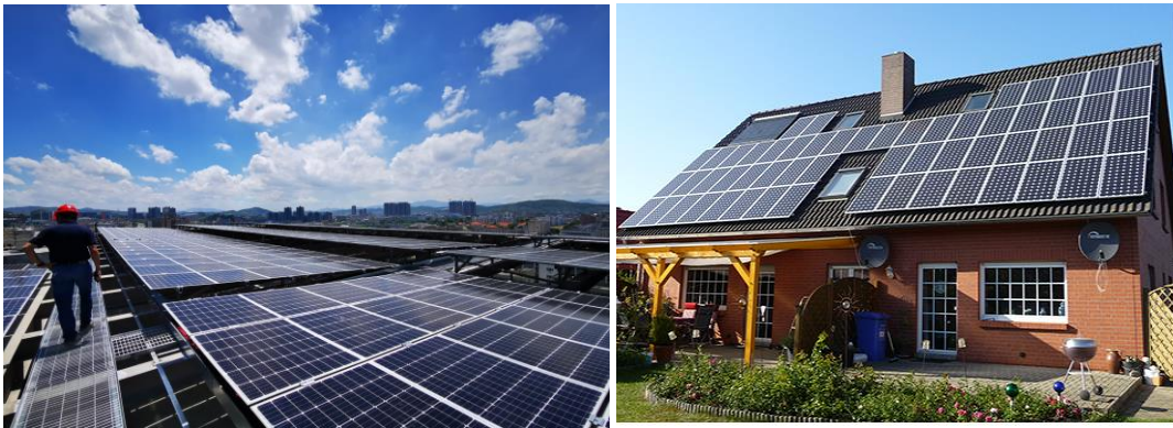
图 2.3 建筑屋顶光伏系统
