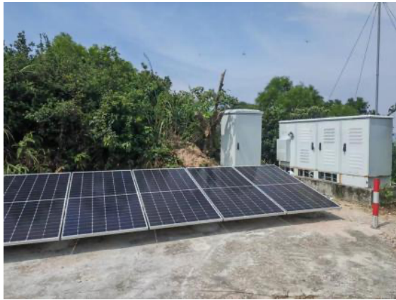
图 21 珠海荷包岛离网 5G 基站示范项目
