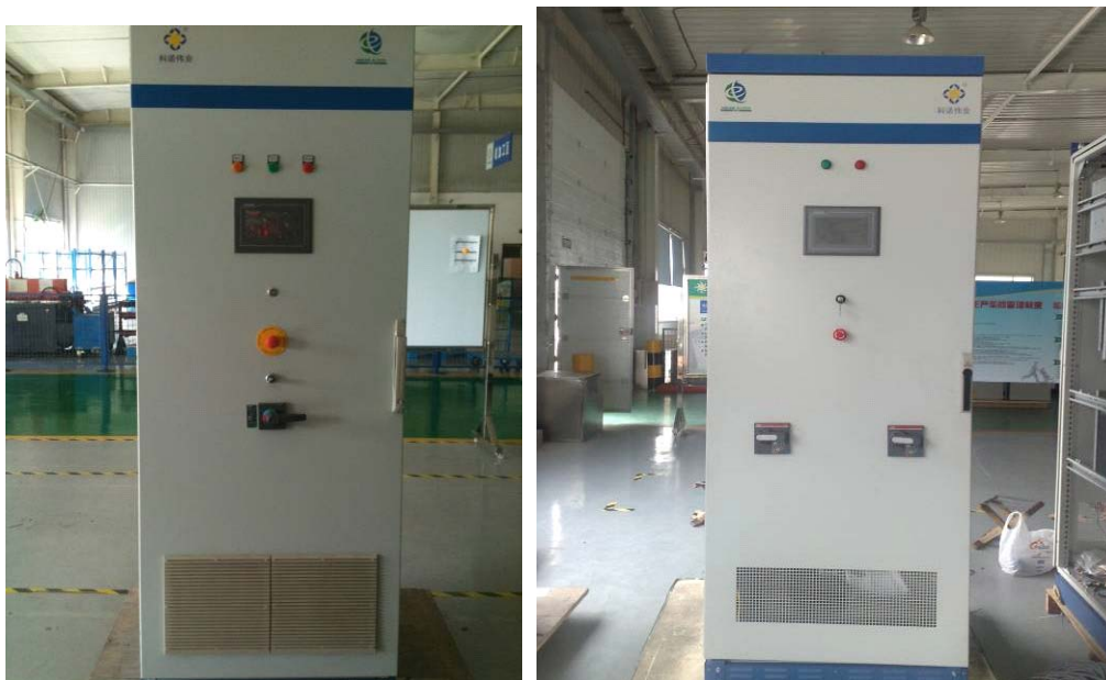
图 3-5 200kVA 自同步电压源型逆变器样机和 150kW 充电控制器样机
