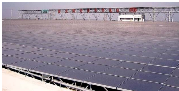
图 4-18 光大环保杜邦太阳能光伏发电工程
