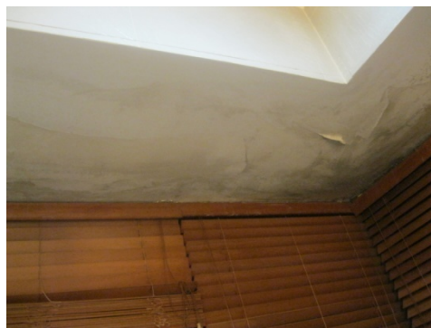
图 39:上海陆家嘴高级公寓冬季 室内墙面结露
