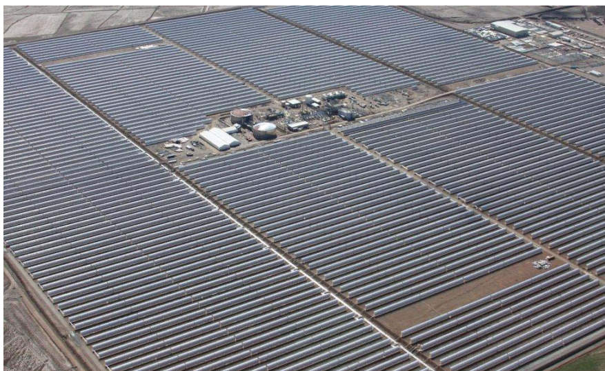
图 15 西班牙 Andasol 1（50MW）槽式发电站
