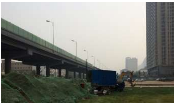
图9. 2016年10月，石家庄市桥西区红旗大街附近一道路施工工地因无法使用市政供电，使用柴油车发电
